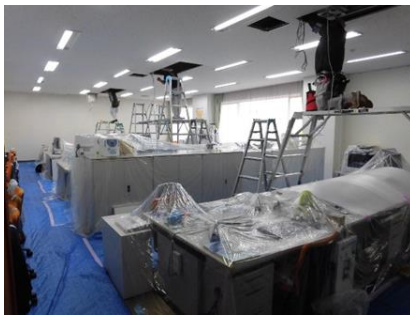
省エネ型空調設備の導入
