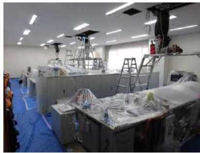
省エネ型空調設備の導入
