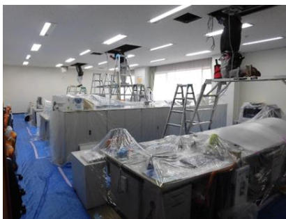
省エネ型空調設備の導入
